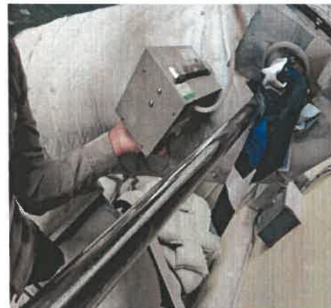
人造石生产线废气排放口 2#
