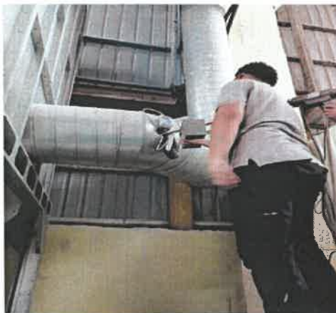
人造石生产线废气处理前 2#
