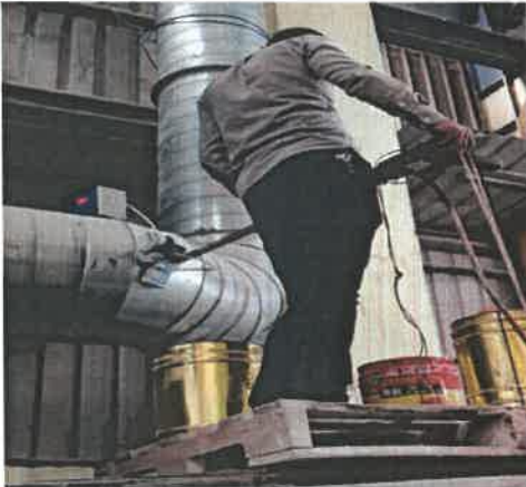
人造石生产线废气处理前 1#
